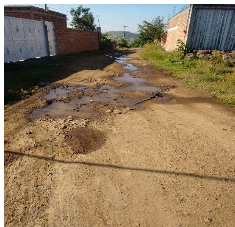
Imagen 4. Esguerrimiento de agua de mangueras rotas conectadas a línea principal. Fuente: Propia (2018).
