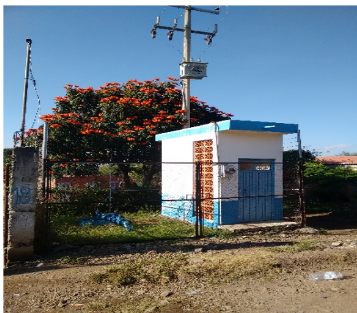
Imagen 1. Pozo de abastecimiento a la localidad en calle 16 de septiembre. Fuente: Propia (2018).
