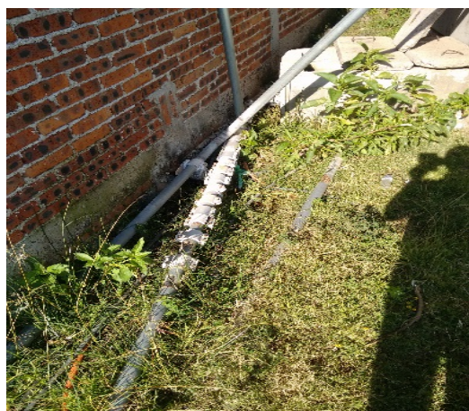
Imagen 3. Conexiones de mangueras a línea principal Fuente: Propia (2018).
