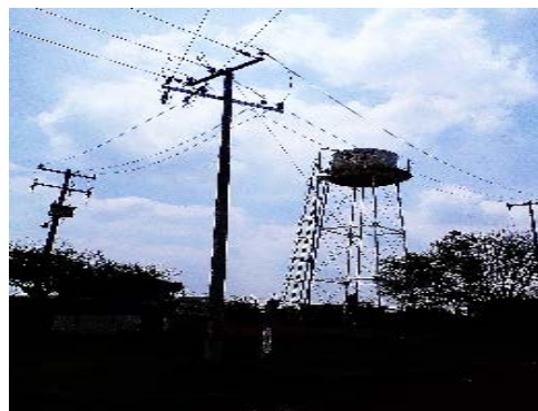
Imagen 3. Red eléctrica en área de pozo. Fuente: Propia (2018).
