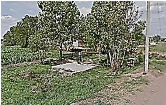
Imagen 1. Cárcamo de rebombeo en mal estado. Fuente: Propia (2018).
