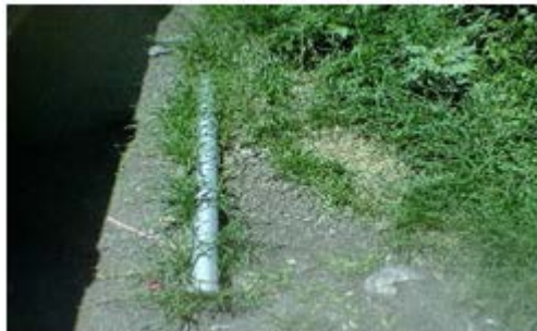
Imagen 3. Línea de distribución de tubo galvanizado. Fuente: Propia (2018).
