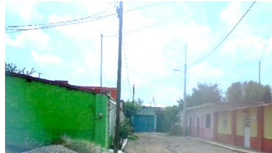
Imagen 7.- Red de energía eléctrica y alumbrado por calle Niños Héroes. Fuente propia 2018.
