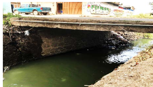
Imagen 5.- Puente de canal de aguas negras lado oriente de la Zahúrda, no se observa paso del drenaje. Fuente propia 2018.
