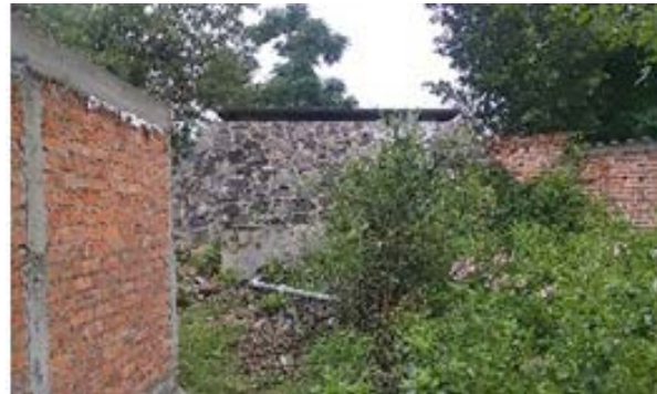
Imagen 2. Tanque superficial de mampostería y línea de conducción. Fuente: Propia (2018).
