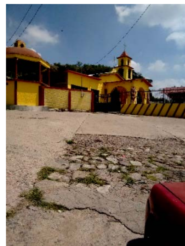
Imagen 6. Calle Ópalo parte frente a la iglesia, cuenta con pavimento de concreto hidráulico en malas condiciones. Fuente: Propia (2018).
