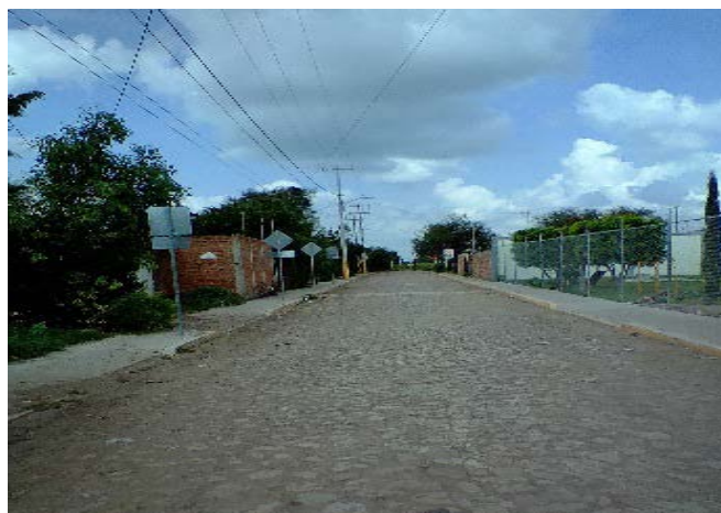
Imagen 4. Cableado del servicio de energía eléctrica de la localidad. Fuente: Propia (2018).
