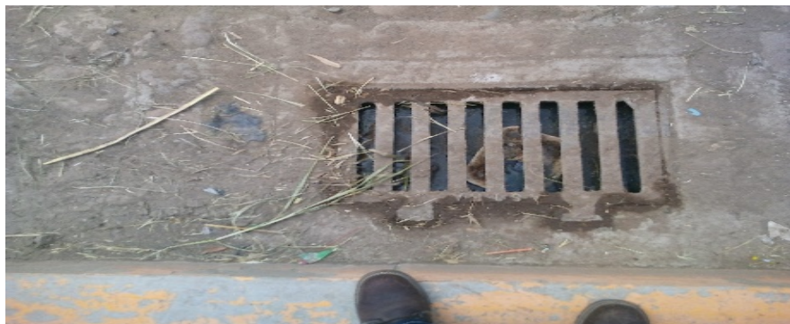
Imagen 3. Daños al sistema de alcantarillado por mal uso de los desechos sólidos. Fuente: Propia (2018).
