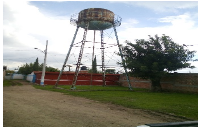
Imagen 2. Tanque elevado de la localidad. Fuente: Propia (2018).
