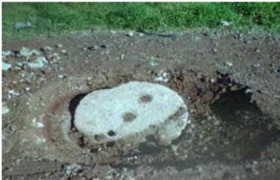
Imagen 4. Pozo de visita azolvado sobre calle 16 de septiembre. Fuente: Propia (2018).
