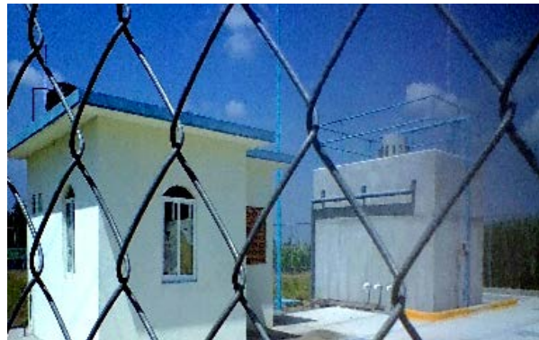
Imagen 6. PTAR sin funcionamiento por no contar con equipos. Fuente: Propia (2018).
