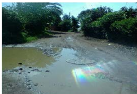
Imagen 9. Calle 16 de septiembre con problemas por falta de pavimentación. Fuente: Propia (2018).
