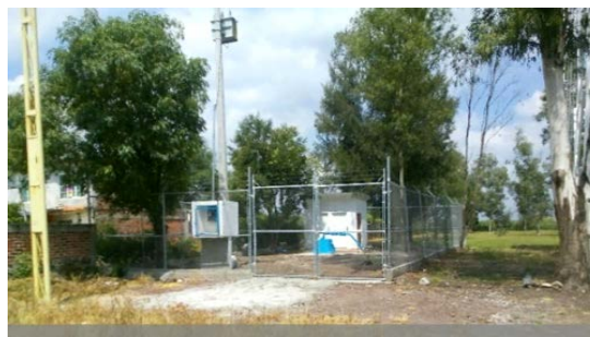
Imagen 2.- Pozo para suministro de agua a la localidad. Fuente: Propia (2018)
