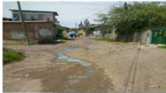
Imagen 6.- Otra vista de drenaje escurriendo por la calle. Fuente: Propia (2018).
