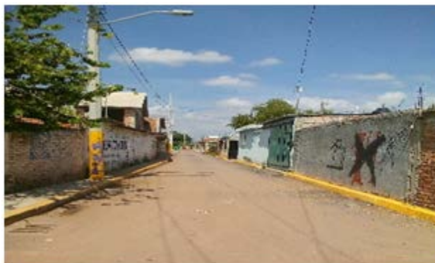
Imagen 6. Estado de guarniciones y banquetas. Fuente: Propia (2018).
