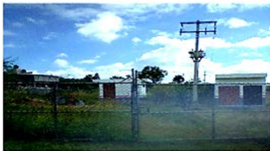
Imagen 3.- Pozo para suministro de agua a la localidad. Fuente: Propia (2018).
