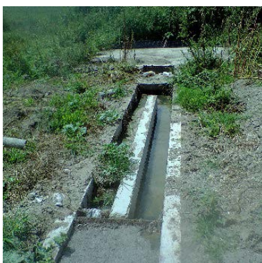
Imagen 5.- PTAR azolvada y sin uso. Fuente: Propia (2018).
