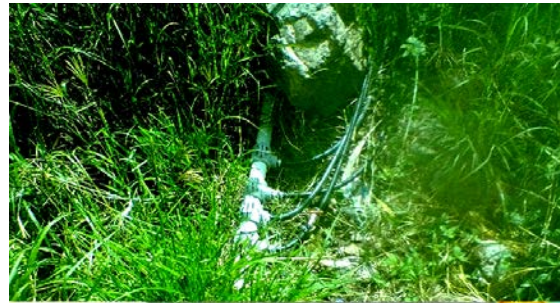
Imagen 2.- Tomas de mangueras directas a línea de abastecimiento en área de tanque. Fuente: Propia (2018).
