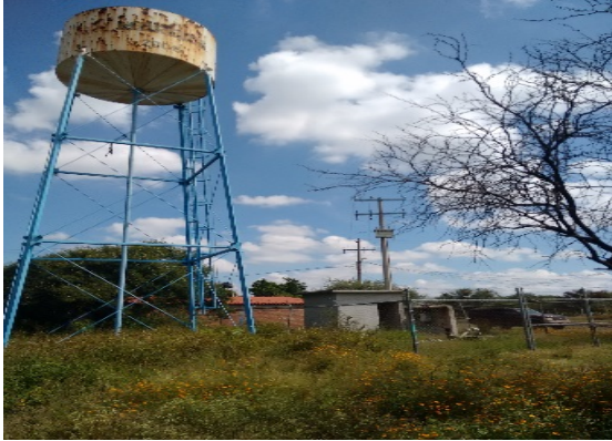
Imagen 1. Tanque elevado y pozo de la localidad ubicados en la calle central. Fuente: Propia (2018).
