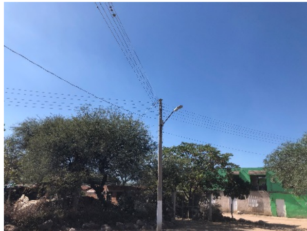
Imagen 5. Se observa red de energía eléctrica y alumbrado público con que cuenta la localidad. Fuente: Propia (2018).
