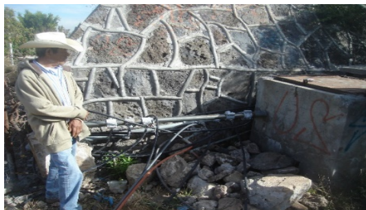
Imagen 2.- Tanque superficial en la zona alta de la localidad, se observan tomas domiciliarias y conexiones directas de la línea de conducción. Fuente: Propia (2018).
