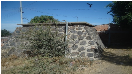
Imagen 1.- Tanque superficial ubicado en la calle Privada 2. Fuente: Propia (2018).
