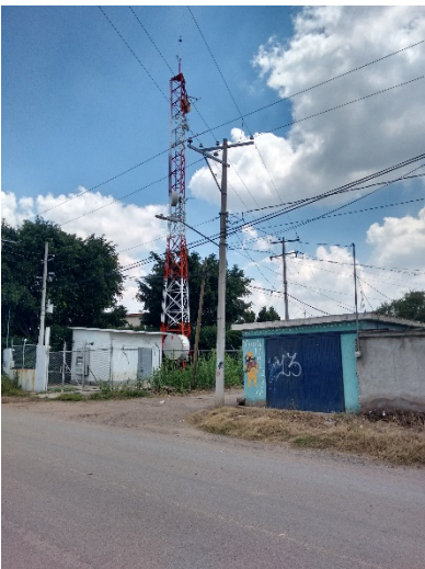
Imagen 7.- Antena de telecomunicaciones sobre Calle Principal. Fuente propia 2018
