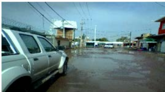
Imagen 5. Calle Pípila pavimento asfalto en malas condiciones. Fuente: Propia (2018).
