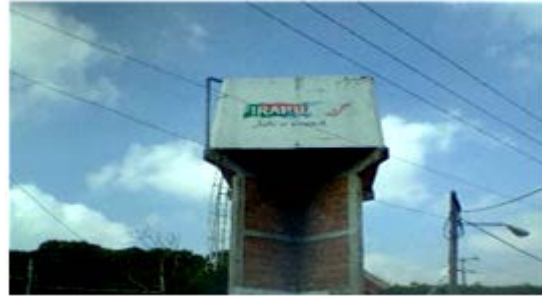
Imagen 2. Tanque elevado de concreto fuera de operación, ubicado en la calle Pípila. Fuente: Propia (2018).
