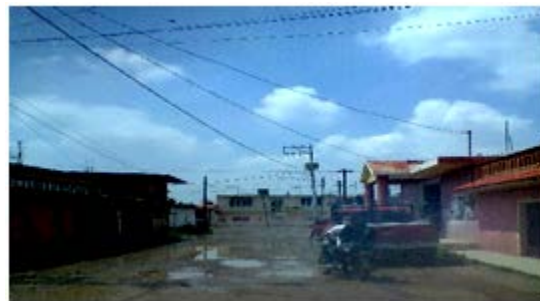
Imagen 6. Calle Pípila pavimento asfalto en malas condiciones. Fuente: Propia (2018).
