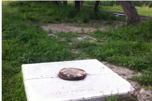
Imagen 1. Pozo profundo de la localidad sin equipamiento. Fuente: Propia (2018).
