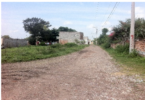
Imagen 7. Calle Primavera sin pavimento. Fuente: Propia (2018).
