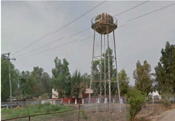
Imagen 3. Tanque elevado fuera de operación, ubicado en la escuela primaria de la localidad. Fuente: Propia (2018).
