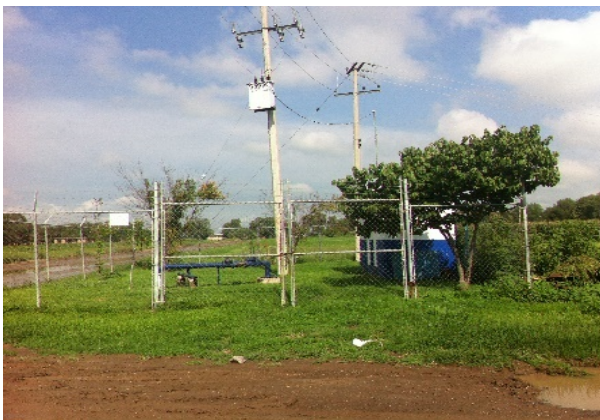
Imagen 1. Pozo de abastecimiento de la localidad con tren de válvulas. Fuente: Propia (2018).
