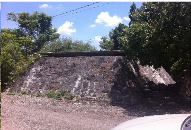
Imagen 2. Tanque superficial de mampostería, sobre la calle Francisco I. Madero. Fuente: Propia (2018).
