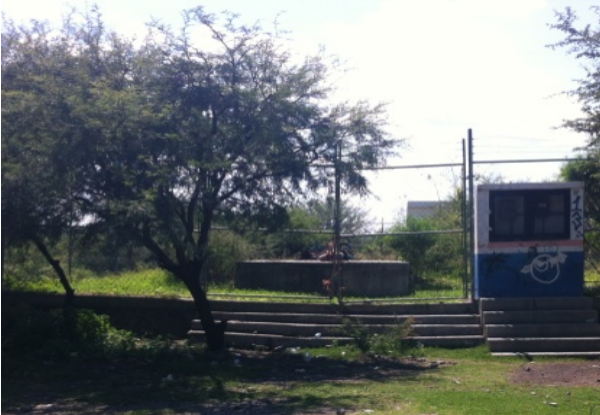
Imagen 6. Instalaciones del RAFA en la localidad, se reporta que el equipo de bombeo no funciona. Fuente: Propia (2018).
