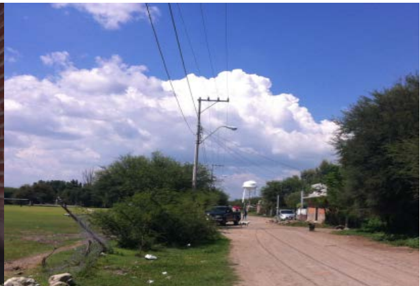
Imagen 13. Red de energía eléctrica y alumbrado público en la calle Mezquite. Fuente: Propia (2018).
