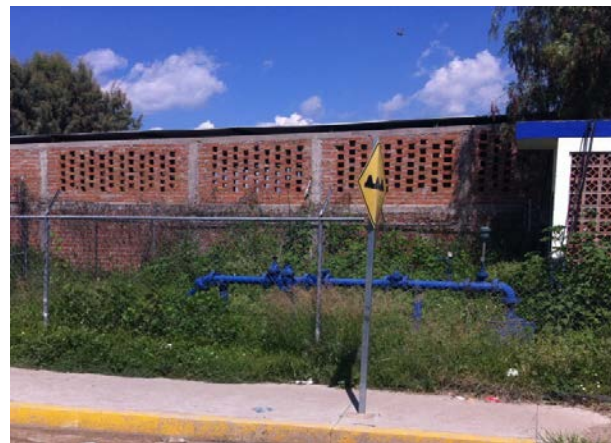
Imagen 5. Tren de válvulas del pozo profundo ubicado en la Calle Mezquite. Este pozo suministra de agua a toda la localidad. Fuente: Propia (2018).
