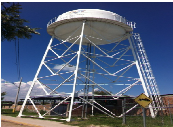
Imagen 4. Tanque elevado ubicado en la calle Mezquite, que proporciona servicio a la localidad. Fuente: Propia (2018).
