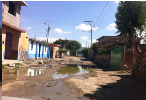
Imagen 15. Calle Pirul, no se encuentra pavimentada. Se observan encharcamientos producto de las lluvias. Fuente: Propia (2018).
