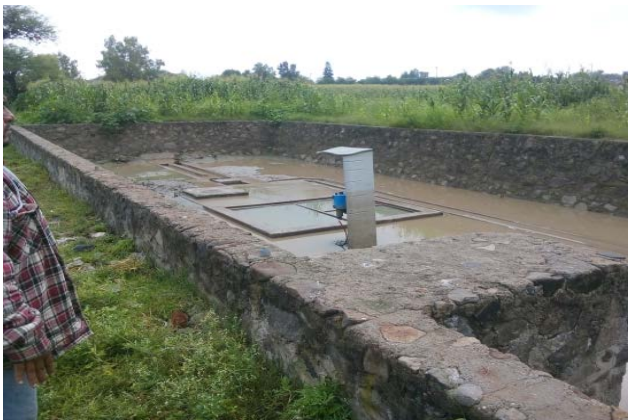
Imagen 2.- planta de tratamiento de aguas residuales fuera de operación, se observa que la infraestructura se inundó. Fuente: Propia (2018).
