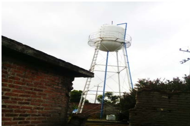
Imagen 1.- Tanque Elevado que suministra el agua a la red de la localidad. Fuente: Propia (2018)
