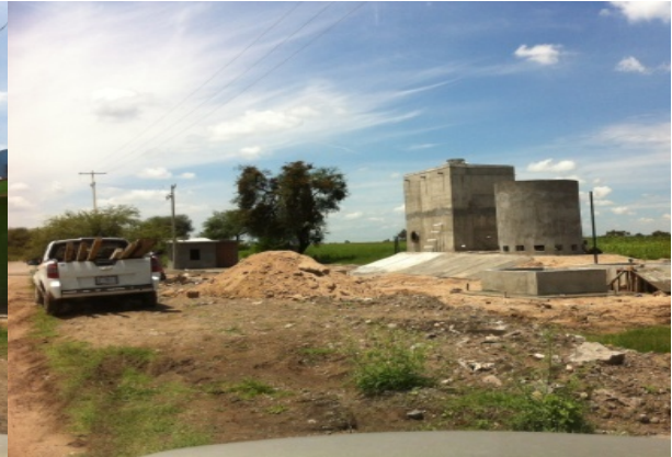
Imagen 3. Planta de tratamiento de aguas residuales para las localidades de Santa Bárbara y Buenos Aires, en proceso de construcción. Fuente: Propia (2018).
