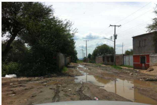
Imagen 16. Aguas residuales que escurren a cielo abierto en la calle Reforma. Fuente: Propia (2018).
