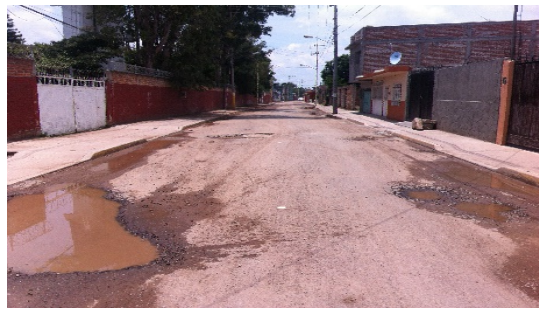
Imagen 2. Calle Berriozabal con problemas de baches. Fuente: Propia (2018).
