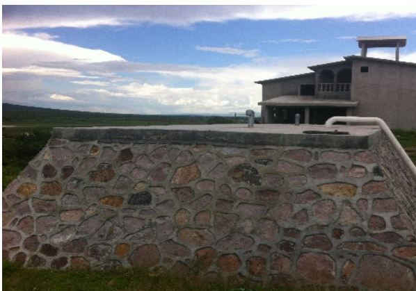
Imagen 1. Tanque superficial, que proporciona servicio a la localidad. Fuente: Propia (2018).
