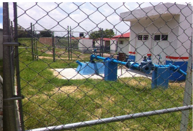
Imagen 2. Treno de válvulas del pozo profundo. Este pozo suministra de agua a toda la localidad. Fuente: Propia (2018).
