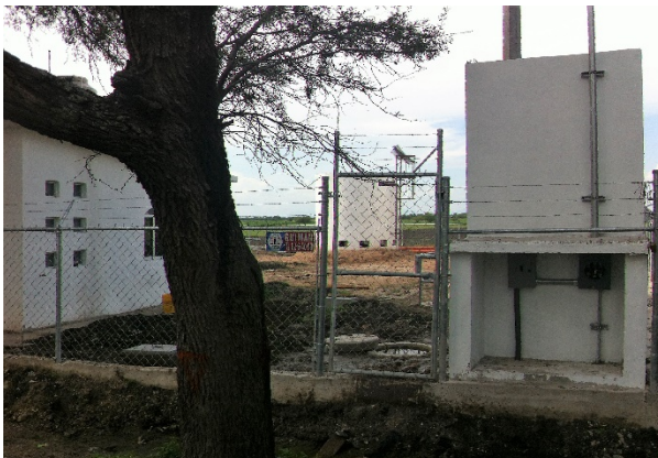
Imagen 5. Planta de tratamiento de aguas residuales para la localidad. Fuente: Propia (2018).
