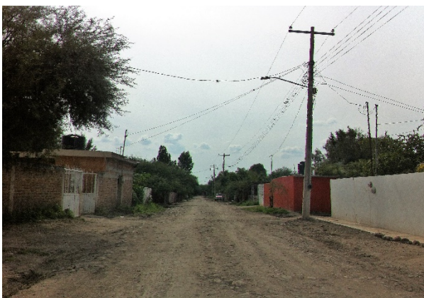
Imagen 7. Calle Calzada de los Rincones, se observa red de energía eléctrica con que cuenta la localidad. Fuente: Propia (2018).
