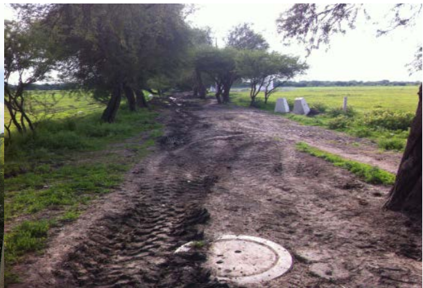
Imagen 6. Red de drenaje en proceso de construcción en la localidad. Fuente: Propia (2018).
