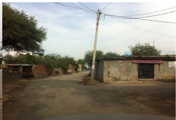
Imagen 8. Calle Chamizal esquina con Hidalgo, red de energía eléctrica. Fuente: Propia (2018).
