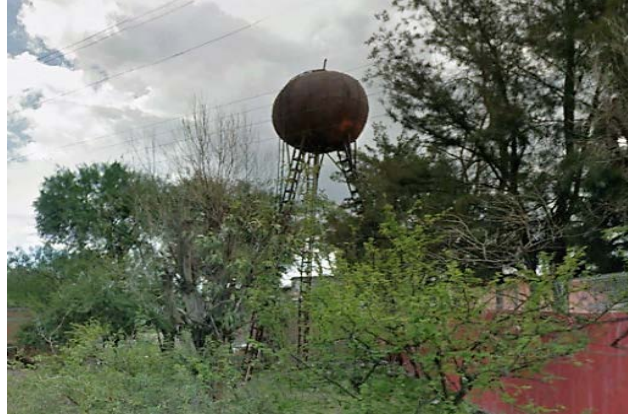
Imagen 3. Tanque elevado, fuera de operación. Ubicado en la calle Adolfo López Mateos.
