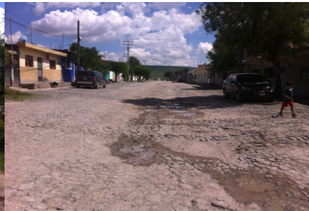
Imagen 10. Calle Francisco I. madero, empedrado en mal estado. Fuente: Propia (2018).
