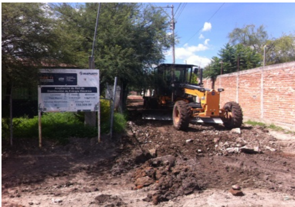
Imagen 4. Trabajos de introducción de la red de drenaje en la localidad, calle Vicente Guerrero. Fuente: Propia (2018).
