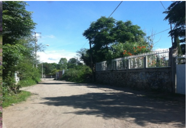
Imagen 10. Calle Alvarado, empedrado en mal estado. Fuente: Propia (2018).
