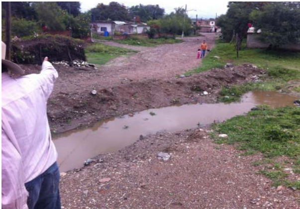
Imagen 9. Calle Hidalgo sin pavimento. Se requiere contar con una alcantarilla para librar el arroyo. Fuente: Propia (2018).
