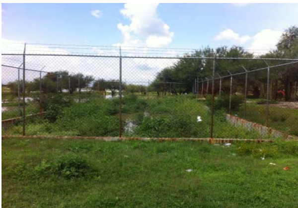
Imagen 4. Planta de tratamiento de aguas residuales tipo RAFA, se observa el nivel del agua hasta la parte superior de la estructura. Fuente: Propia (2018).
