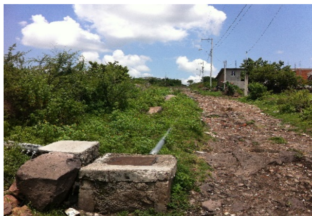
Imagen 4. Calle Independencia, tubería expuesta. Fuente: Propia (2018).
