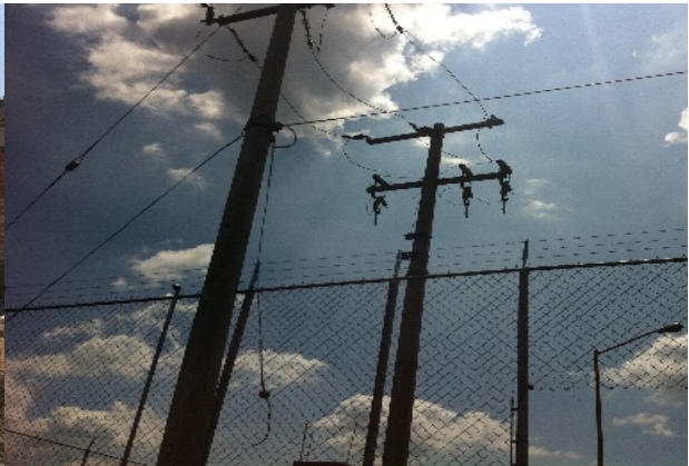
Imagen 10. Calle La purísima, se observa red de energía eléctrica con que cuenta la localidad. Fuente: Propia (2018).
