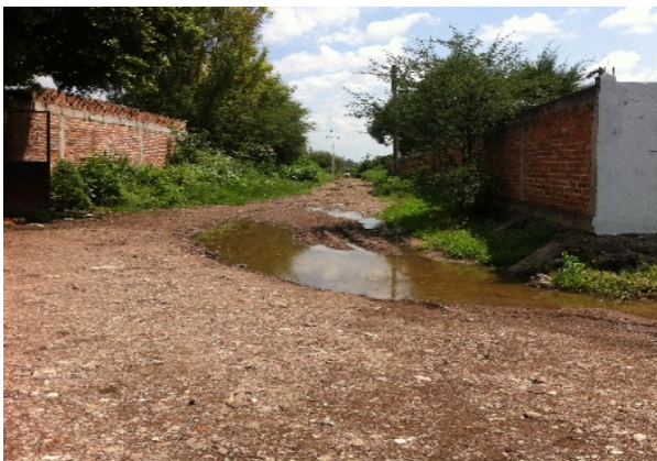
Imagen 5. Problemas por falta de tubería de drenaje, calle Benito Juárez. Fuente: Propia (2018).
