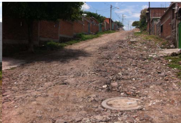
Imagen 6. Tapa y brocal de pozo de visita de la red de drenaje en la calle Guerrero. Fuente: Propia (2018).
