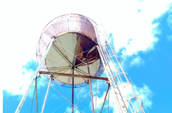
Imagen 3. Se observa la corrosión en el tanque metálico. Fuente: Propia (2018).
