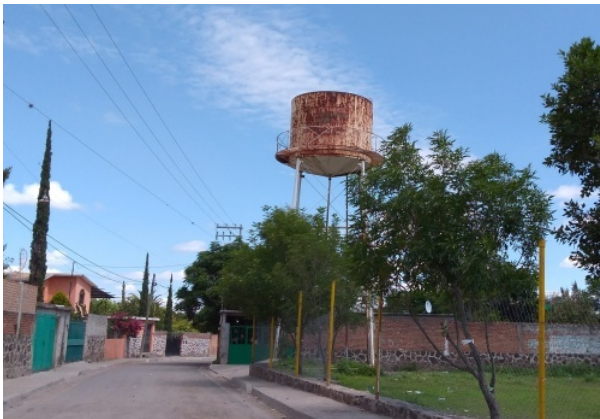
Imagen 1. Tanque metálico elevado, ubicado en la Avenida de los Insurgentes. Se observa el mal estado de conservación del mismo. Fuente: Propia (2018).
