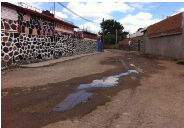
Imagen 14. Calle Aldama no cuenta con pavimento. Fuente: Propia (2018).
