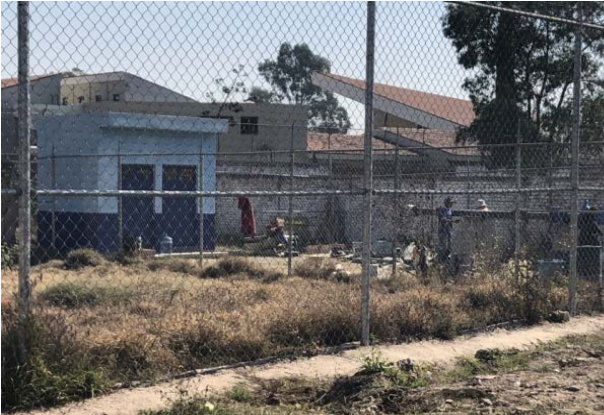
Imagen 3. Nueva fuente de abastecimiento en proceso de equipamiento, ubicado en el bulevar Arandas. Fuente: Propia (2018).
