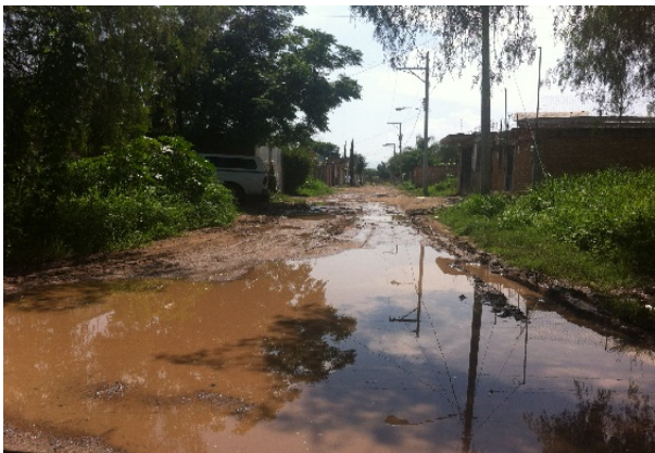
Imagen 4. Problemas por anegamiento de la segunda privada 12 de Diciembre. Fuente: Propia (2018).
