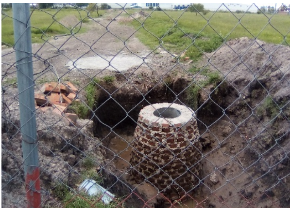
Imagen 4. Pozo de visita de conexión con línea de Castro del Rio, continuación del drenaje de la calle Emiliano Zapata. Fuente: Propia (2018).
