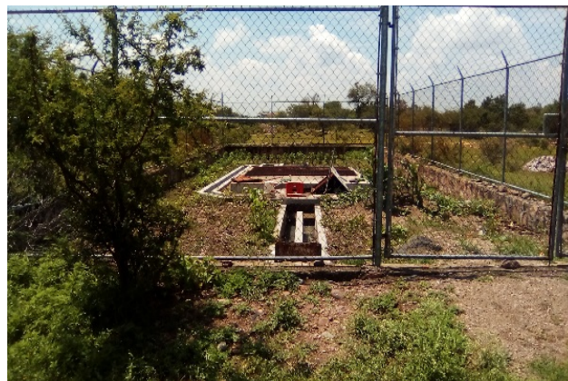
Imagen 4. Planta de tratamiento. Fuente: Propia (2018).
