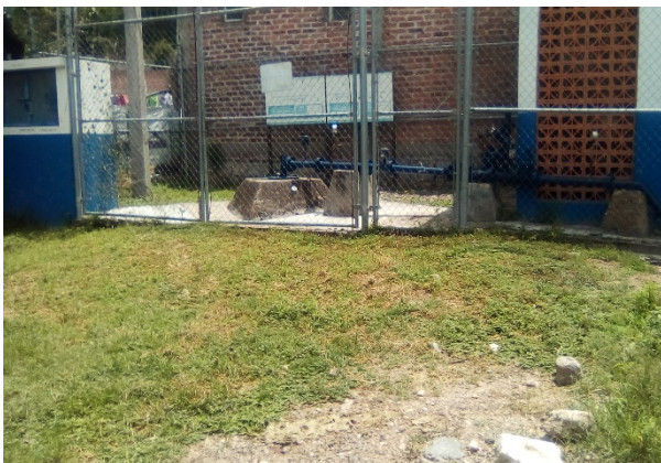
Imagen 1. Pozo de agua. Fuente: Propia (2018).
