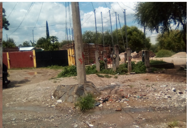
Imagen 5. Tomas de Energía eléctrica sobre calle Hidalgo. Fuente: Propia (2018)
