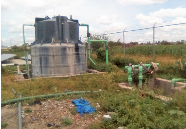
Imagen 3. Planta de tratamiento. Fuente: Propia (2018).
