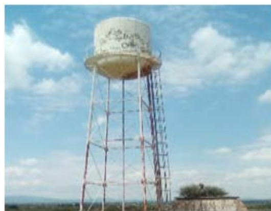
Imagen 4. Tanque metálico elevado y tanque superficial sin uso. Fuente: Propia (2018).
