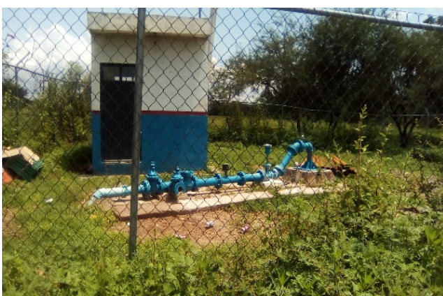
Imagen 3. Pozo de agua. Fuente: Propia (2018).
