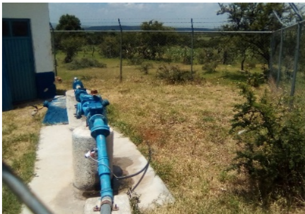
Imagen 1.- pozo que suministra el agua al sistema de la localidad de Santa Rosa de Temascalío Fuente: Propia (2018).
