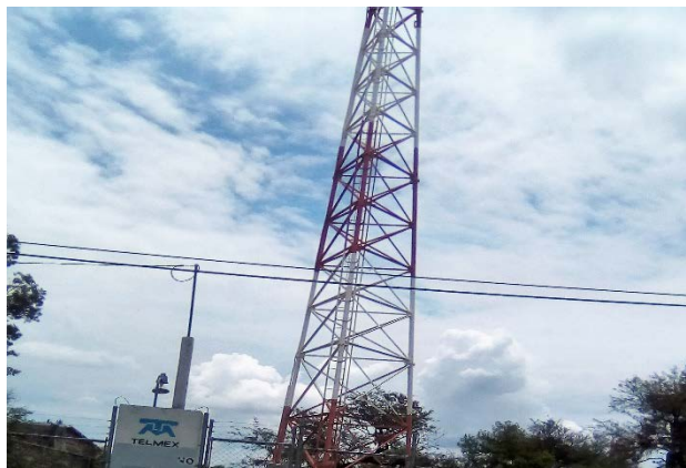
Imagen 7. Antena de telecomunicaciones. Fuente: Propia (2018).
