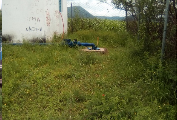
Imagen 2. Pozo de agua calle Guadalupe Victoria. Fuente: Propia (2018).
