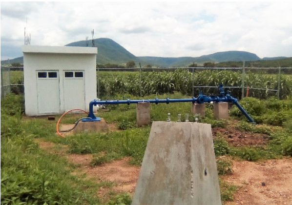
Imagen 3. Pozo de agua nuevo en zona oriente. Fuente: Propia (2018).
