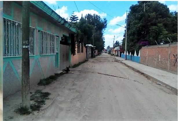
Imagen 4. Red de energía eléctrica y telefonía sobre calle real. Fuente: Propia (2018)
