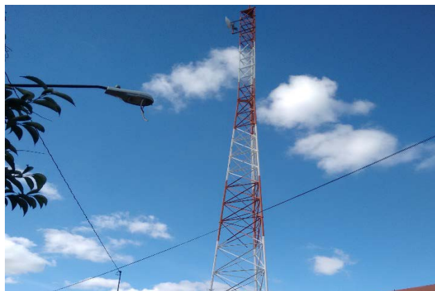
Imagen 5. Antena de telecomunicaciones. Fuente: Propia (2018).
