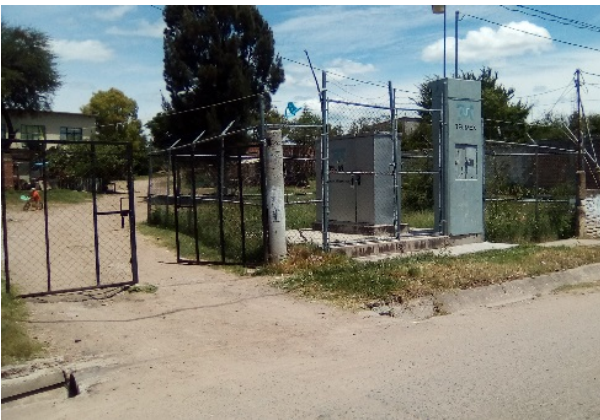
Imagen 10. Central de tipo gabinete de Telmex. Fuente: Propia (2018).
