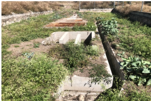
Imagen 19. Planta de tratamiento de aguas residuales. . Fuente: Propia (2018).
