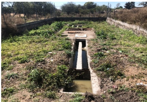
Imagen 7. planta de tratamiento. Fuente: Propia (2018).
