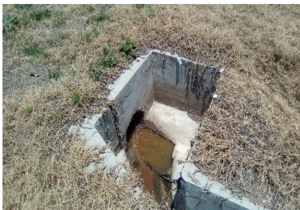
Imagen 5. Llegada de drenaje a planta de tratamiento. Fuente: Propia (2018).
