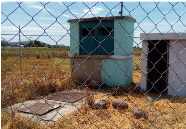
Imagen 3. Pozo de agua. Fuente: Propia (2018).
