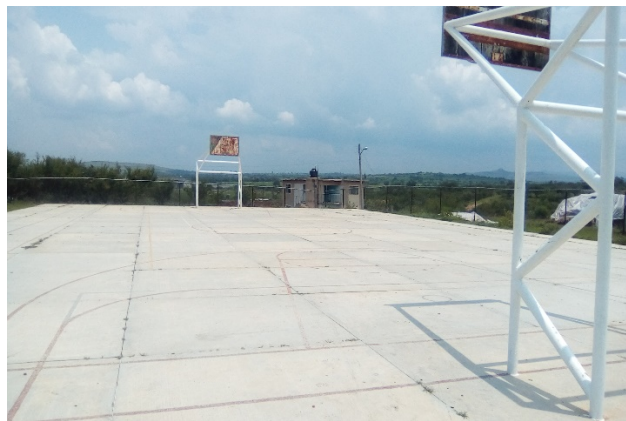
Imagen 13. Cancha de usos múltiples. Fuente: Propia (2018)
