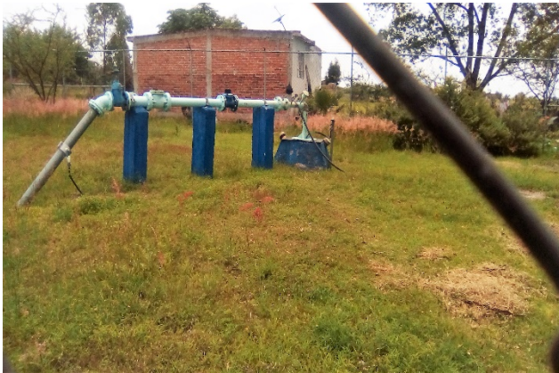
Imagen 1. Pozo de agua. Fuente: Propia (2018).
