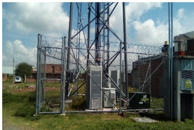
Imagen 10. Antena de telecomunicaciones. Fuente: Propia (2018).
