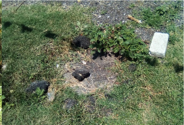
Imagen 7. Pozo de visita en con tapa de madera, azolvado. Fuente: Propia (2018).
