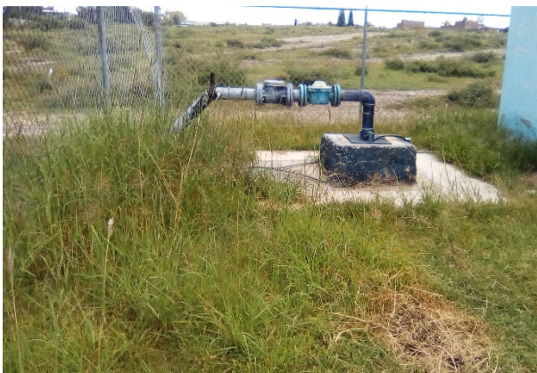
Imagen 2. Pozo de agua. Fuente: Propia (2018).
