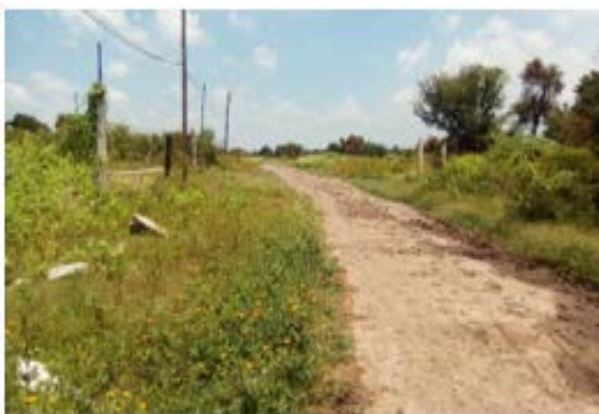
Imagen 8. Calle Veracruz con material de terracería en la localidad. Fuente: Propia (2018).
