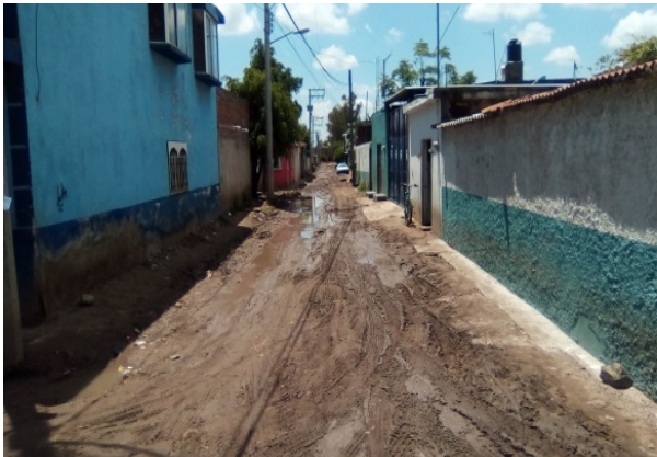
Imagen 7. Calle Benito Juárez, falta de la red de drenaje. Fuente: Propia (2018).
