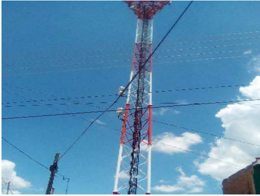
Imagen 8. Antena telecomunicaciones. Fuente: Propia (2018)
