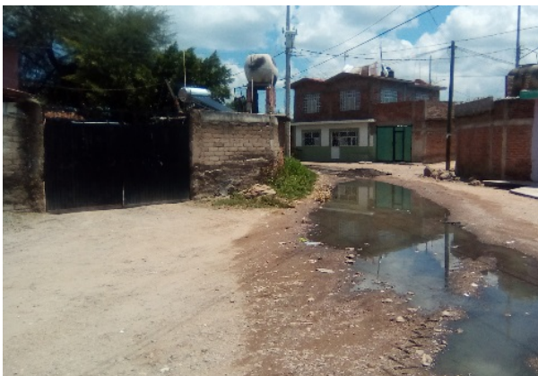
Imagen 13. Calle Juárez pavimentada en asfalto con desgaste por escurrimientos. Fuente: Propia (2018).
