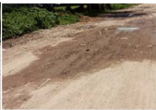
Imagen 10. Calle 16 de septiembre sin pavimentar. Fuente: Propia (2018).
